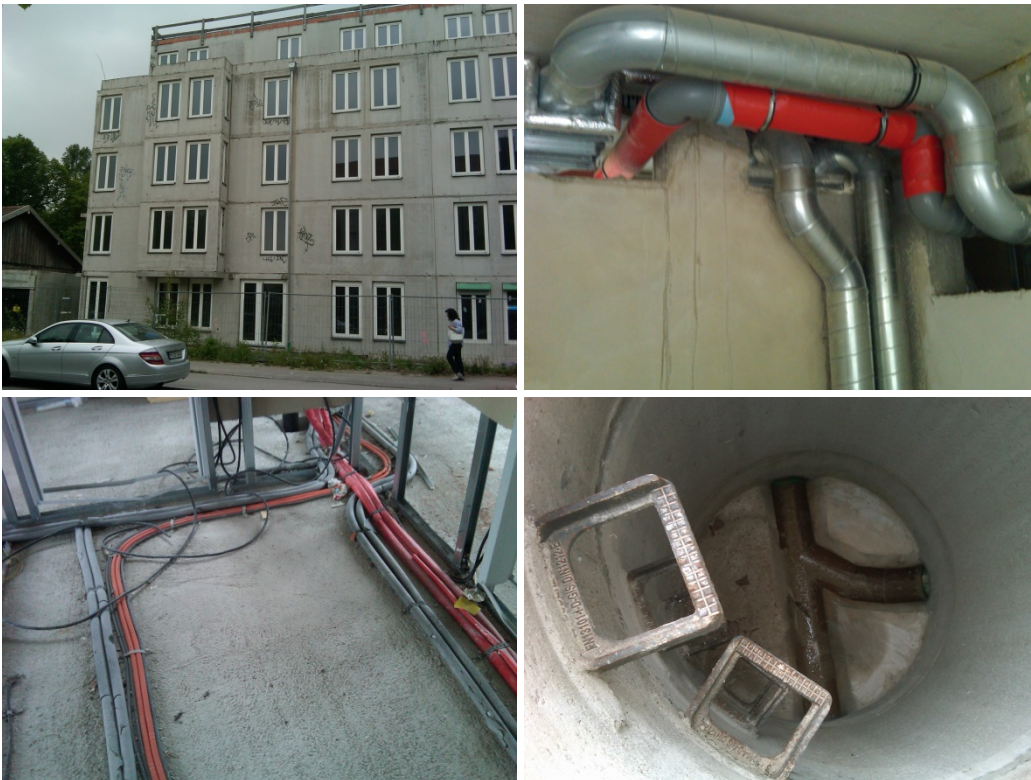
Außenansicht (o l), Lüftungsinstallationen (o r), Heizleitungen (u l), Abwasserschacht (u r)
